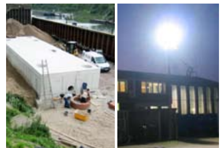
Weitere ÖKOPROFIT-Maßnahmen bei Hülskens: Regenauffangbecken und energiesparende LED-Beleuchtung
