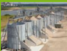
Modernste Kies- und Sand-Silos
